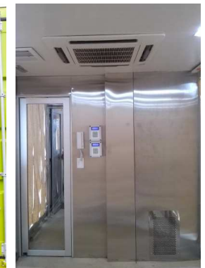
Interior Cámara Crecimiento
