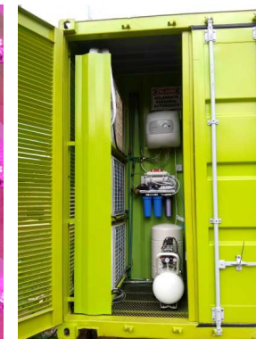
Sala de Máquinas
